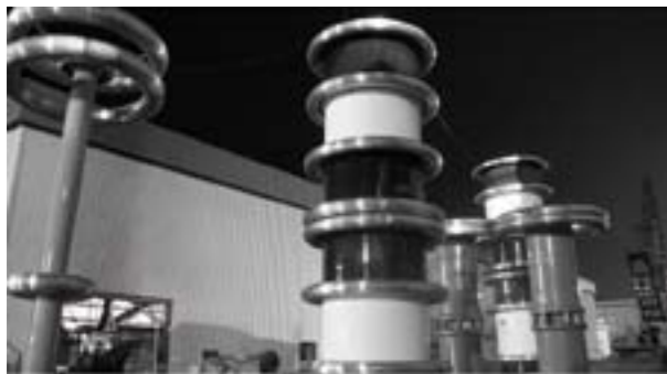
图11 岭澳核电站二期3号机现场交接试验
