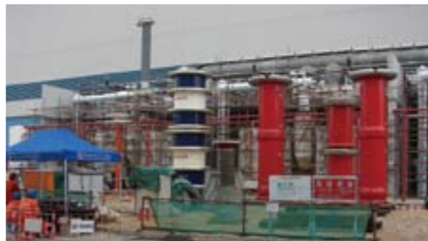
图12 岭澳核电站二期4号机现场交接试验
